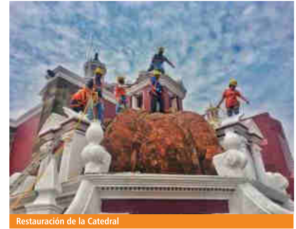
Restauración de la Catedral
